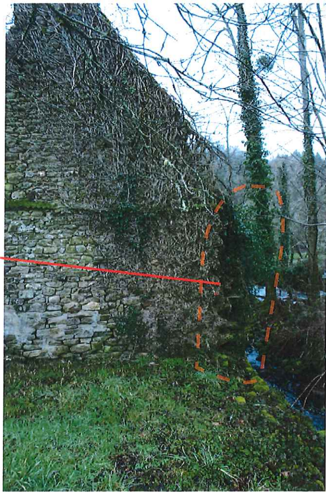
Angle effondré à reconstruire
